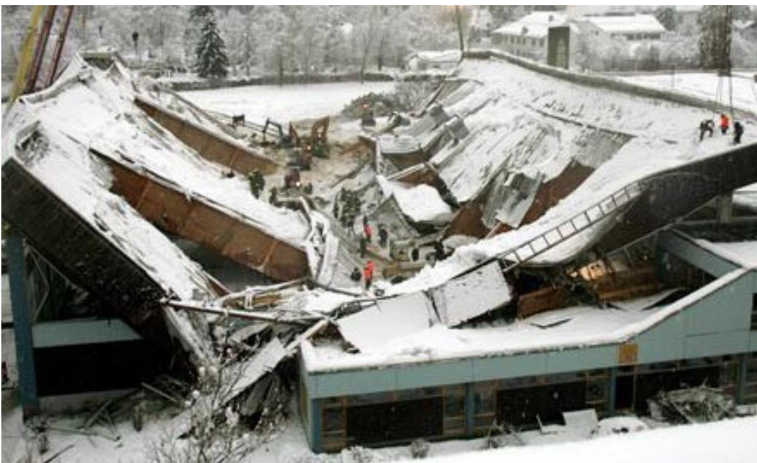
Abb. 1: Dacheinsturz einer Sporthalle (M.BALAK 2006, S1, https://www.deutschlandradio.de/ )
